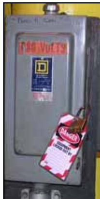
Figura SEGURIDAD-1: Ejemplo de un mecanismo de Bloqueo/Etiquetado en un panel de fuente de alimentación
